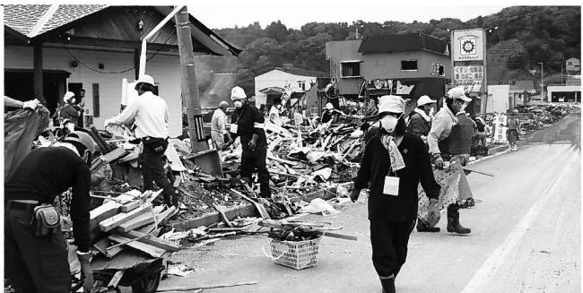
▶歩道の泥よけやがれきの撤去をするボランティア(=平成23年5月21日、宮城県石巻市)
