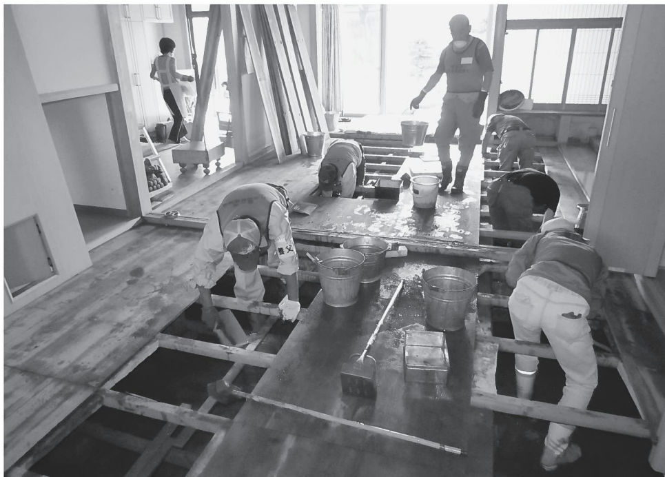
▶戸田地区で床上浸水した民家。一日も早い復旧を願いながら床下に溜まった水と泥をかき出すボランティア（＝9月19日、戸田地区）
